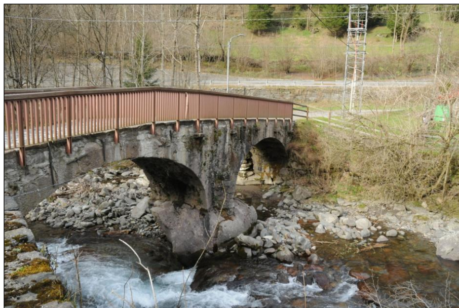
Figura 24 – Ponte di Gavazzo sul Fiume Serio verso i Forni e la pista ciclopedonale
